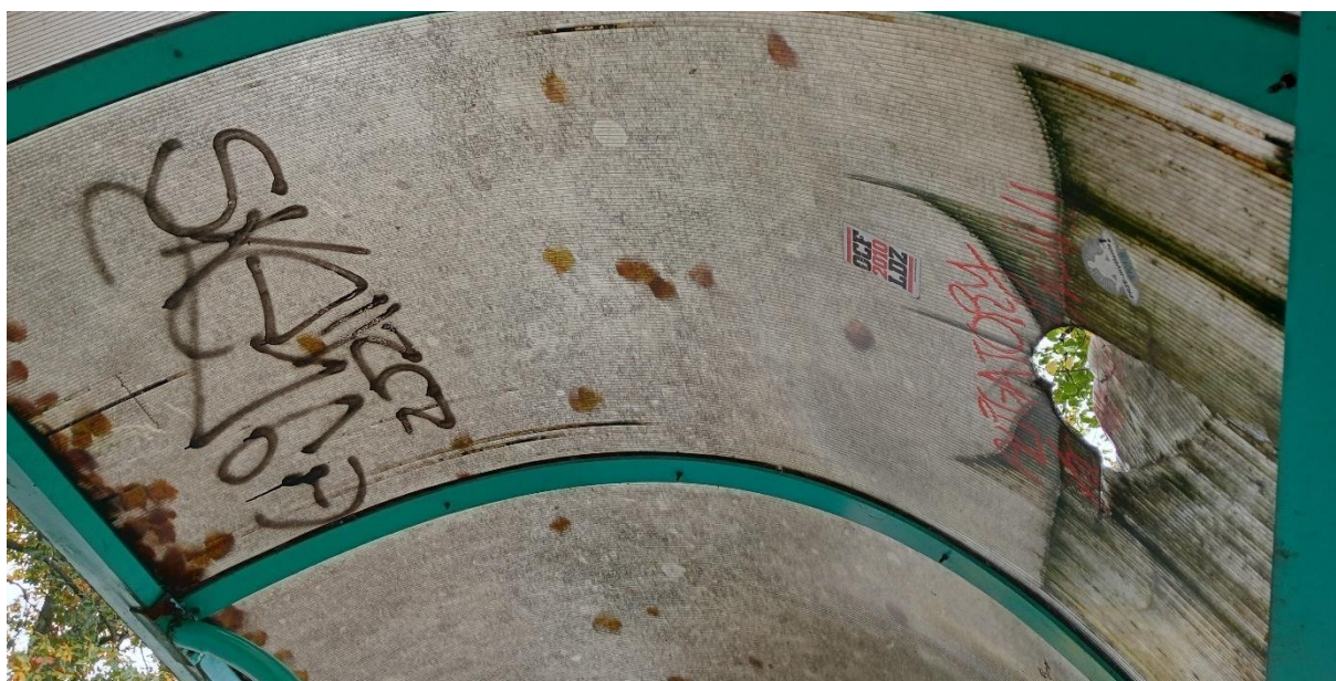
Rycina 21. Zdeastrowana wiata przystanku autobusowego na obszarze rewitalizacji
