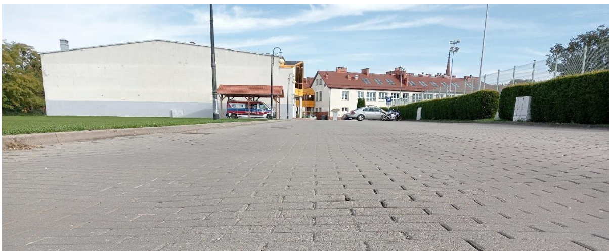
Rycina 29. Stan nawierzchni drogi dojazdowej do kompleksu sportowo-rekreacyjnego.
