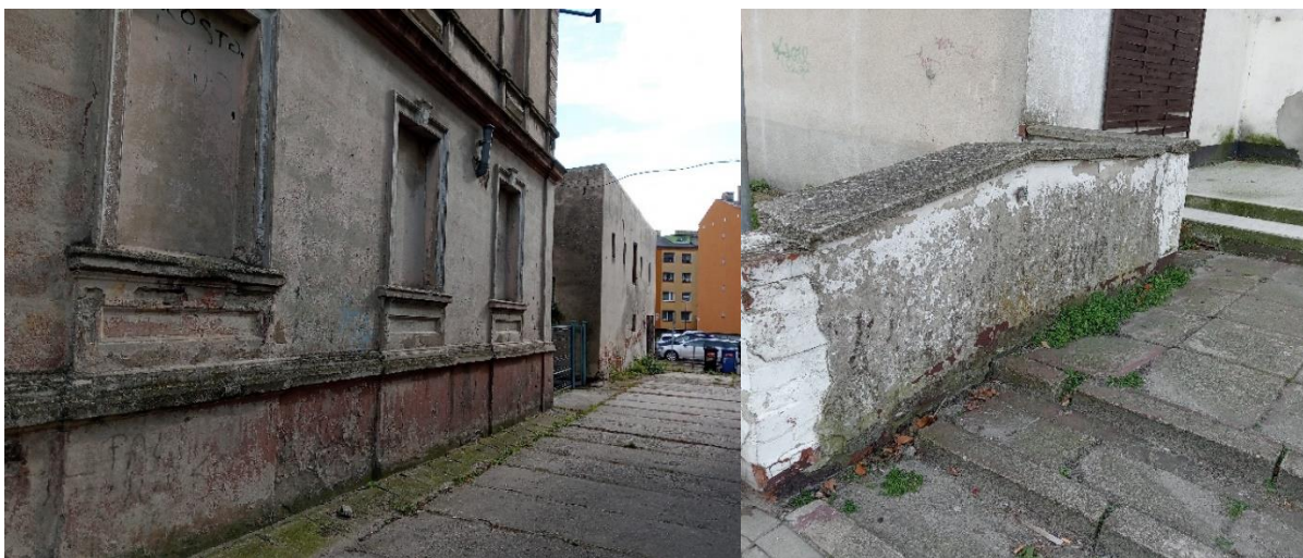
Rycina 26. Elementy przestrzeni w złym stanie technicznym
